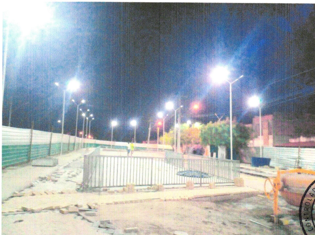
Foto 10 - POSTE DE DUAS PÉTALAS EM AÇO PINTADO NA COR BRANCA - ALTURA 6.00 m - LÂMPADA LED 40W
